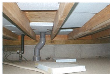
脱落したボード系断熱材
