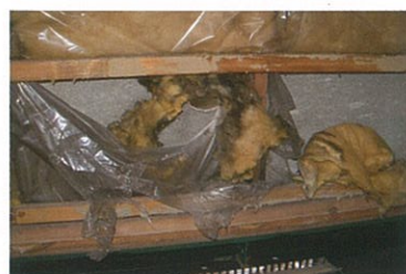
結露により劣化した断熱材
