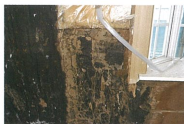
結露によりカビが生えた断熱材
